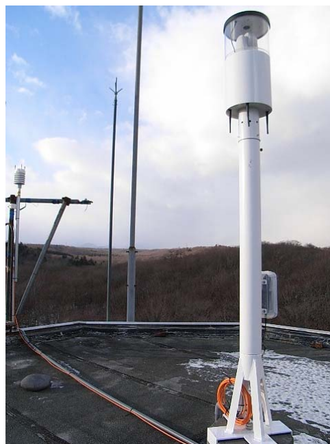
図6-1 フィールドサーバーの設置状況
