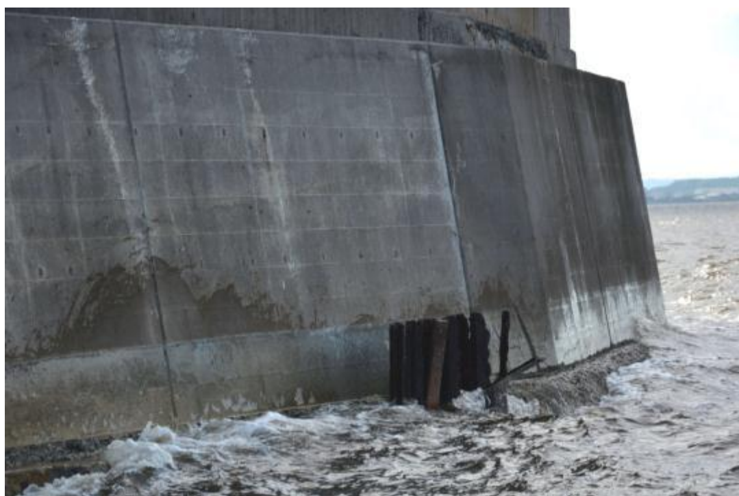
写真 4－8－2 老朽化する三池島の外壁（2024 年 8 月 3 日）
