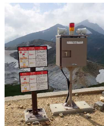
火山ガス警報・注意報を発令するための火山ガス検知器・注意標識 (2018.7.20)
