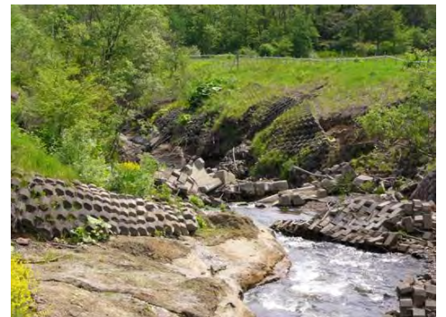
川底が削られた河川④ (拡幅による流速低下策や河床安定のための たけの工作物設置を計画:国土交通省)
