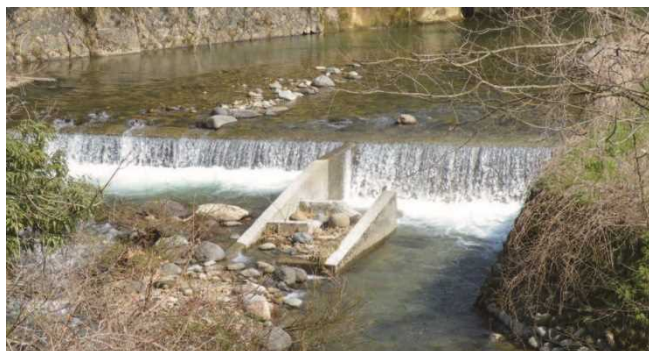
①過去に設置された魚道が破損
