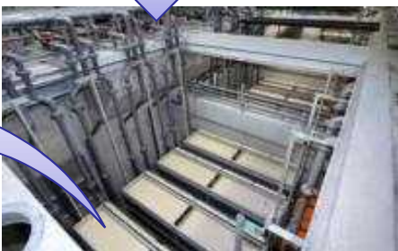
反応タンク内の膜ユニット(俯瞰)
