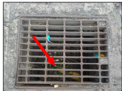
写真 29 雲出大橋の橋梁上の排水溝内に生育するセイヨウナタネ
