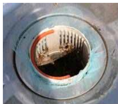
図C．洗い場の排水系統に設けられた網
