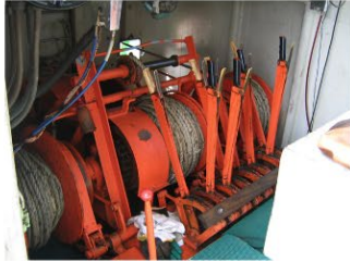
1. ウィンチ (機材を上下運搬する)
