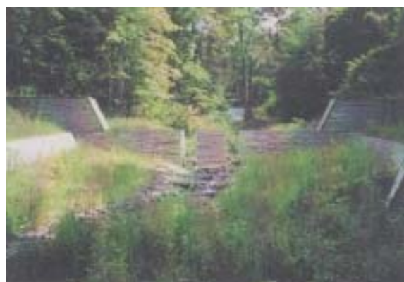
野々沢川に設置されたスリット式魚道
