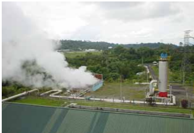
ラヘンドン地熱発電所拡張事業(インドネシア) (イメージ)
