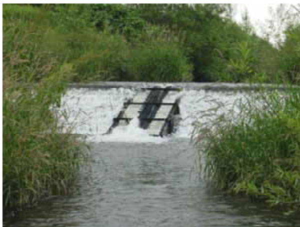
写真2 設置された魚道
