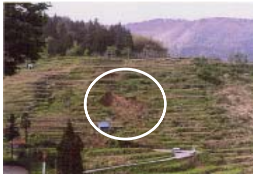
耕作放棄地の法面崩壊
