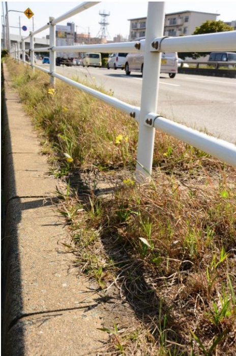
写真 37 須恵川橋の橋梁上の植栽柵内に生育するセイヨウナタネ
