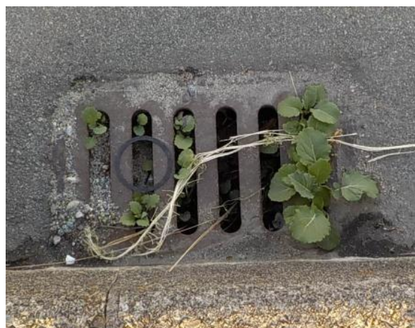
写真 30 雲出大橋の橋梁上の排水溝内に多数生育するセイヨウナタネ
